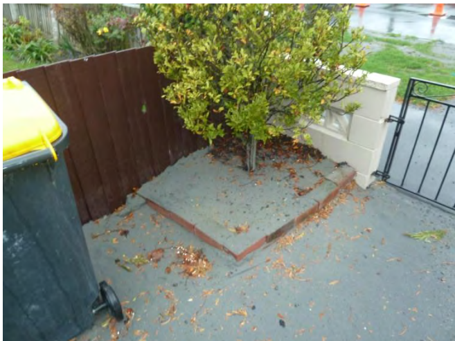
e) Liquefaction ejecta
