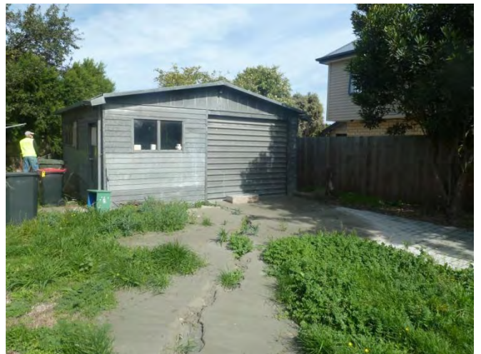
l) Liquefaction ejecta on lawn
